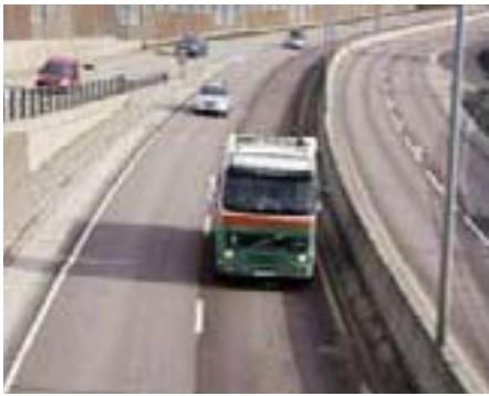
Det var når vogntog kjørte over kumlokk som dette i forgrunnen, at det løsnet og fløy over i motsatt kjørebane.
